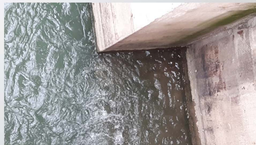
deversarea in rau, la functionarea fara injectie de aer
